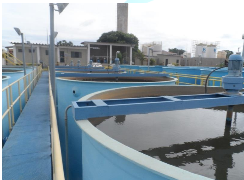
FIGURA 34: FLOCULADOR MECÂNICO INSTALADO NA ETA BOA ESPERANÇA.
