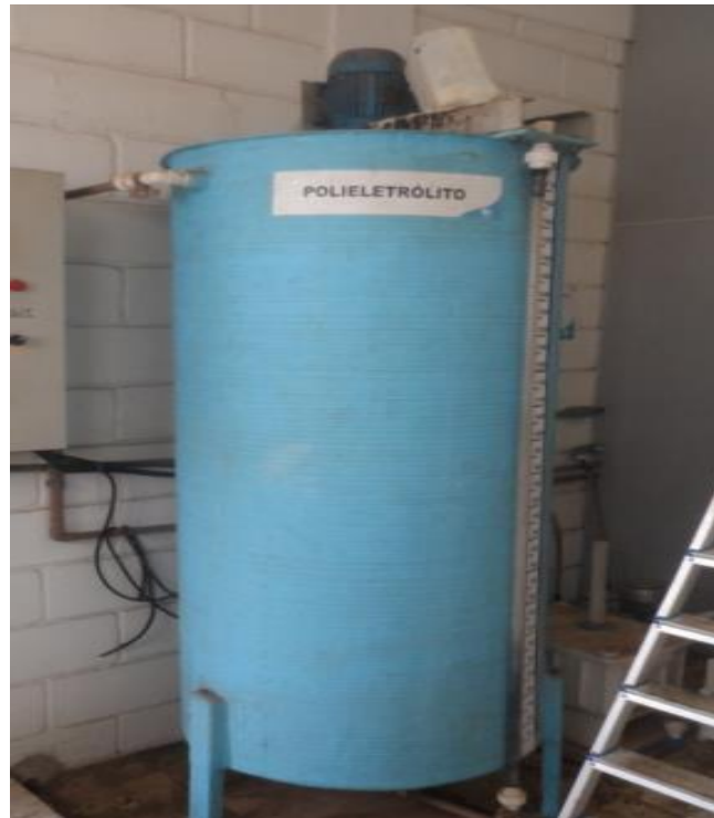
FIGURA 41: SALA DE PREPARAÇÃO E DOSAGEM DE PRODUTOS QUÍMICOS.
