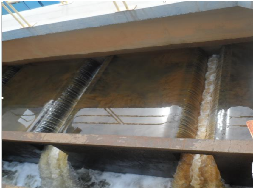
FIGURA 36: FILTROS INSTALADOS NA ETA – BOA ESPERANÇA.
