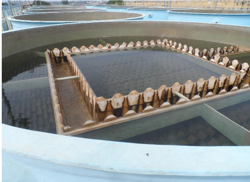
FIGURA 35: DECANTADORES INSTALADOS NA ETA – BOA ESPERANÇA.
