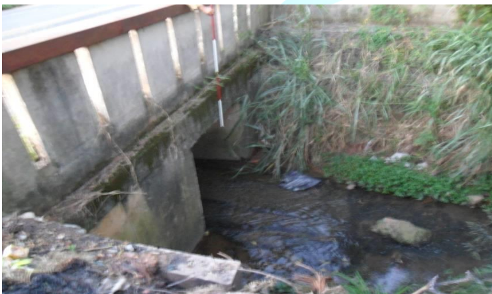
FIGURA 74: GALERIA EM CONCRETO JD GIRASSOL - FONTE: PDDUSH.
