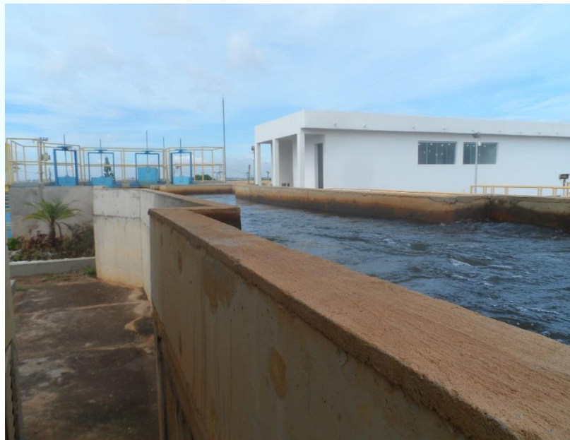
FIGURA 33: CANAL DE CHEGADA DA ÁGUA BRUTA NA ETA-BOA ESPERANÇA.
