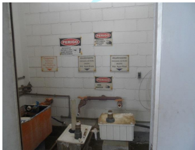
FIGURA 40: SALA DE PREPARAÇÃO E DOSAGEM DE PRODUTOS QUÍMICOS.
