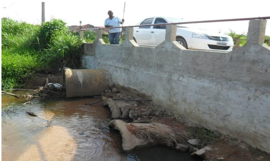
FIGURA 78: JARDIM INTERLAGOS - CÓRREGO SANTA CLARA - ASSOREAMENTO - PDDUSB.
