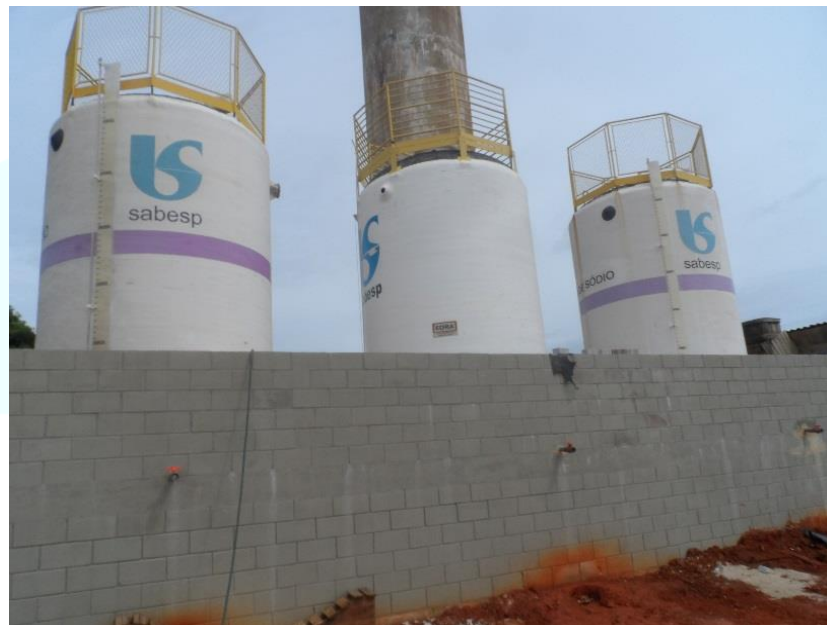
FIGURA 39: ARMAZENAMENTO DE PRODUTOS QUÍMICOS.
