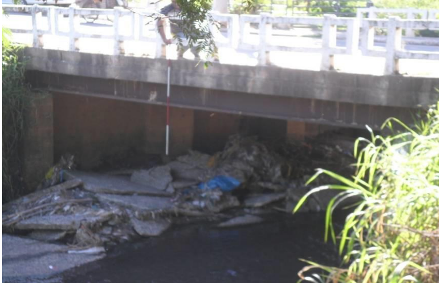
FIGURA 75: PONTE VILA INEMA, MÁS CONDIÇÕES DE CONSERVAÇÃO E ASSOREAMENTO POR ENTULHOS - PDDUSH.
