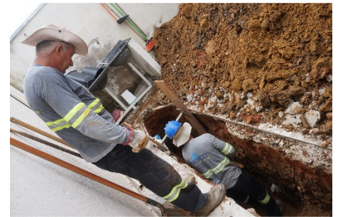
Hortolândia avança rumo aos 100% de esgoto coletado e tratado
